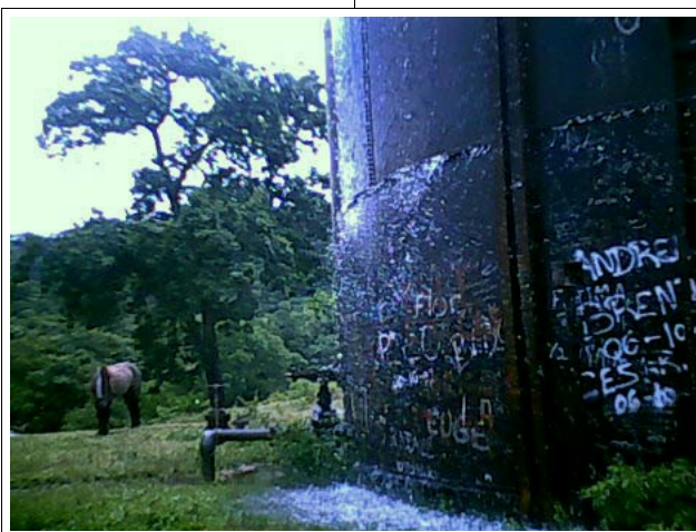
Este es el depósito de agua que sirve a la población de Mosconi. La foto muestra el estado de abandono en el que se encuentran las instalaciones concedidas a la empresa Aguas del Norte, por parte del clan que "gobierna" la provincia de Salta.
